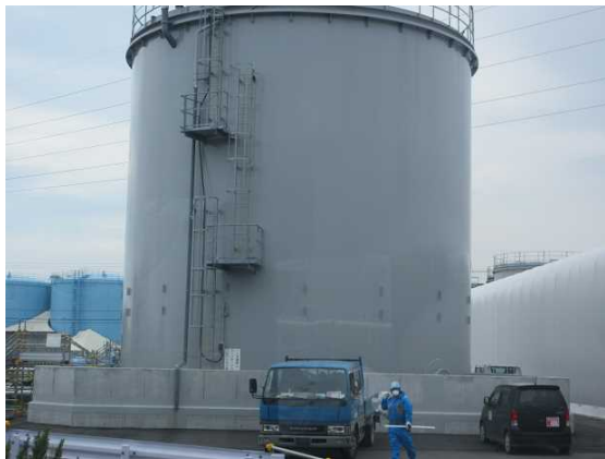
汚染水タンクの大きさを実感頂けますでしょうか？
